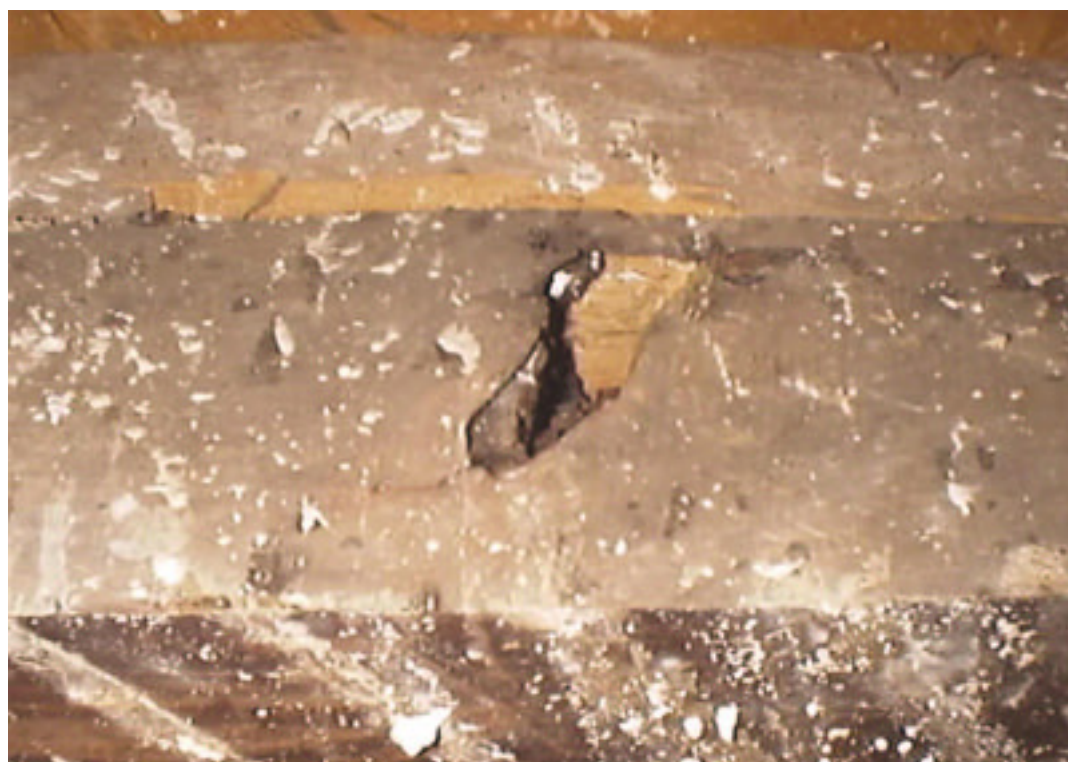
Fotografía 30. Se observa otra falla natural de menor entidad en un tirante de madera dura. No compromete su estado de conservación.
