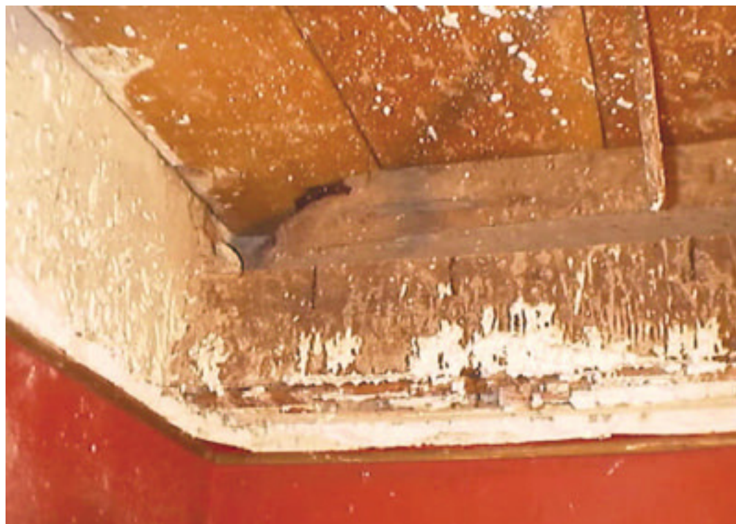
Fotografía 24. Se detecta que el regrueso aplicado sobre la viga no lo cubre totalmente, lo que no ocurre en la generalidad de los casos. Debe regularizarse en caso de que esta conformación se mantenga, si bien no representa una situación crítica ni mucho menos.
