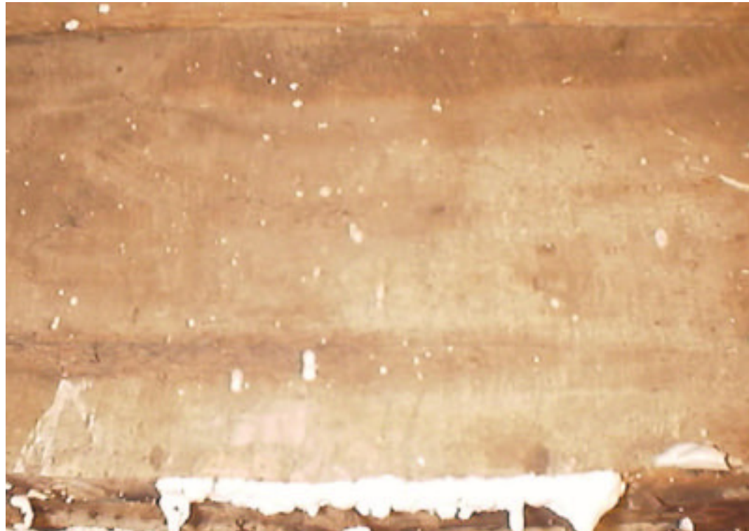
Fotografía 23. Se aprecia claramente el tipo de corte con que fueron conformadas este tipo de vigas. Dichos cortes irregulares se deben a que fueron aserradas a mano.
