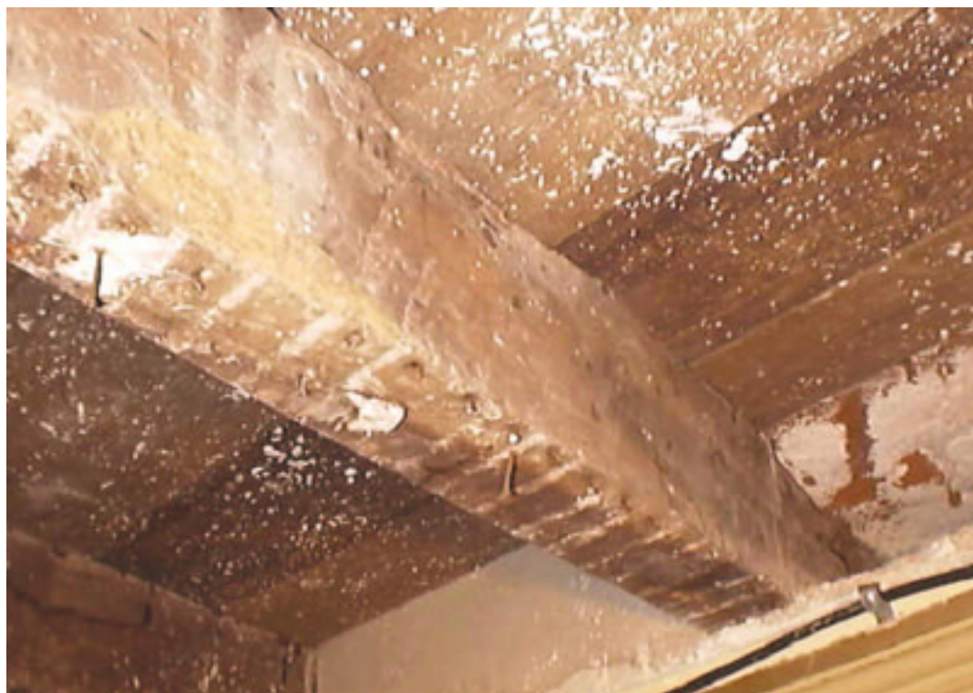
Fotografía 26. Vista del tirante para el cual se realizó el cateo de su apoyo en el muro maestro, en cuyo vértice derecho inferior se observa claramente el sector de sámagu, que incluso penetra conjuntamente con la madera propiamente dicha (duramen) en el muro. Esta situación es generalizable para la mayoría de los tirantes.
