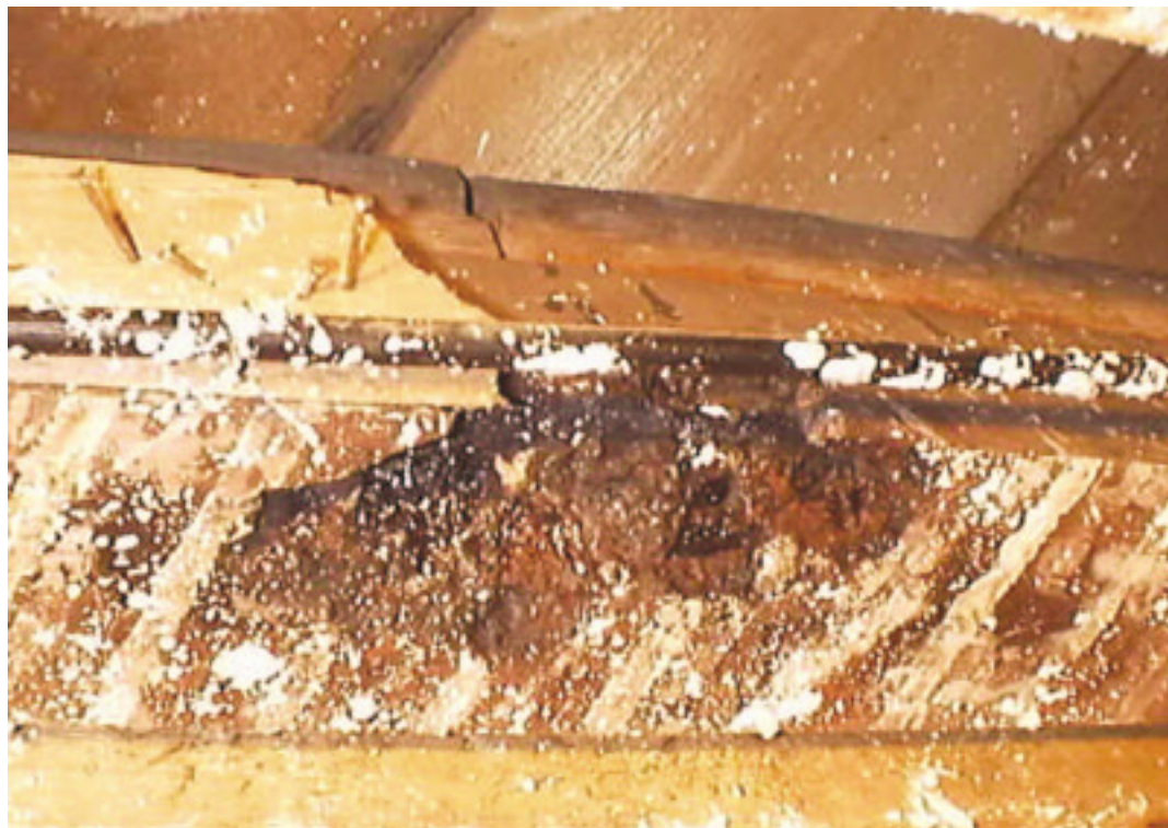
Fotografía 28. Sector B. Se observa una falla natural en el tirante de madera dura, que no altera en absoluto su estado de conservación. Se extrae muestra.
