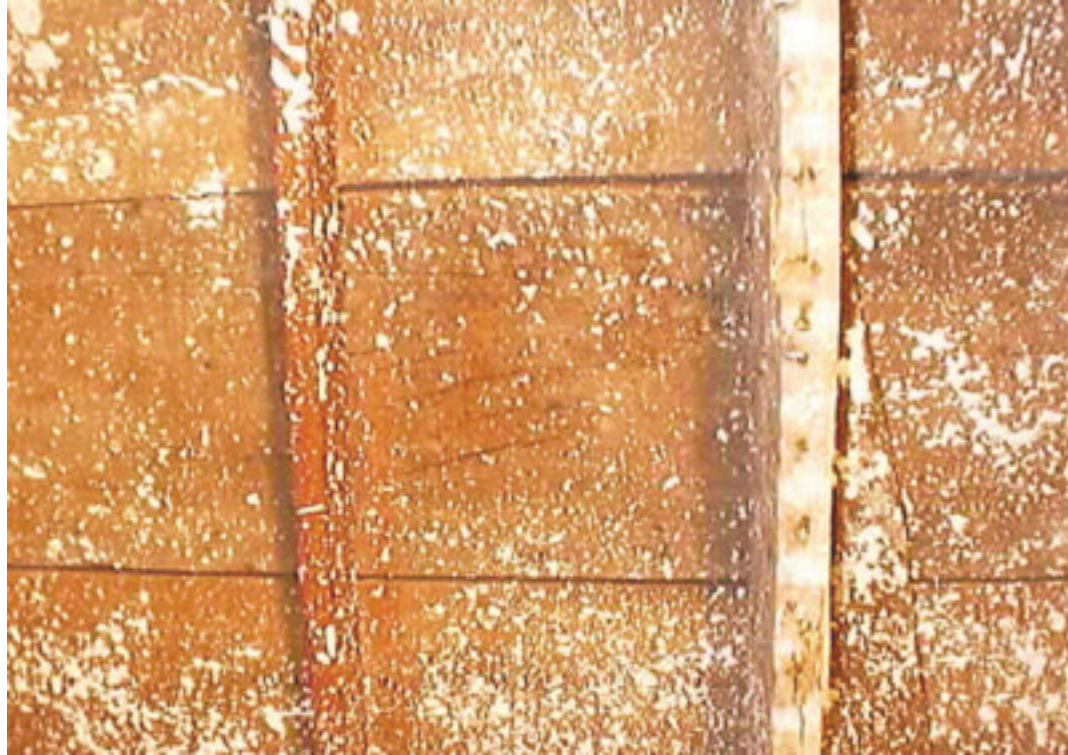
Fotografía 27. Registro de un sector de superficie aproximada de 0,30 x 0,30 m de entablado sobre el ambulatorio "acorchado" (mal estado de conservación). Se aprecia que a ambos lados de este sector el entablado se encuentra en perfecto estado. Ésta es la única falla del entablado que se encontró en este nivel.
