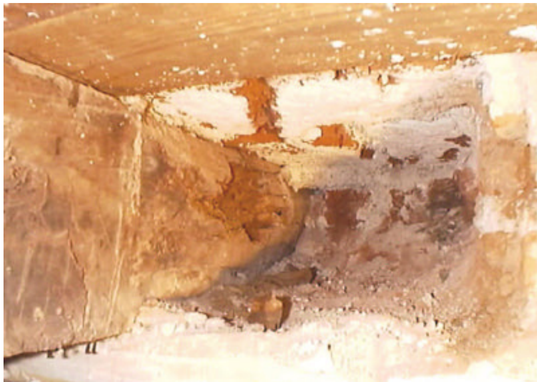
Fotografía 25. Se observa un cateo realizado por la Dirección de Obra sobre uno de los muros maestros. En él se aprecia el sector de viga incorporado en el muro, que muestra la parte de sámagu acorchada pero la parte de madera propiamente dicha en excelente estado de conservación.
