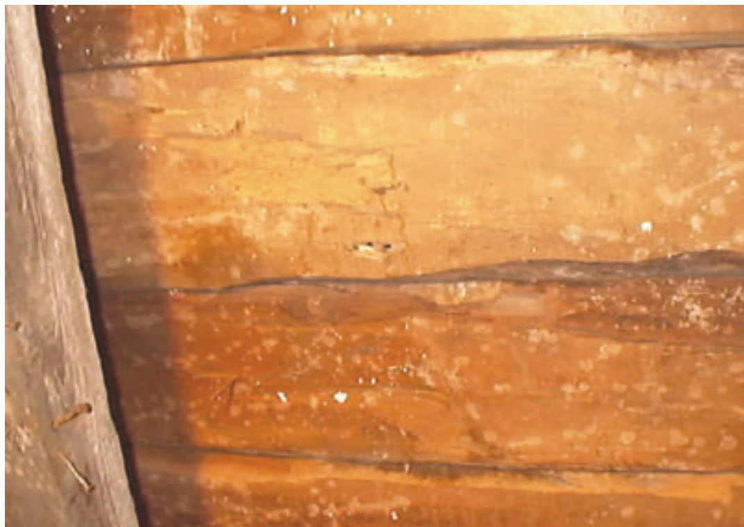
Fotografía 39. Sector A. Se observa el mal estado del entablado de 1 ½». La madera propiamente dicha se encuentra apolillada en distintos sectores y conformada por retazos en otros, lo que obliga a su sustitución. Se extrae muestra. La tirantería de madera dura se encuentra en excelente estado de conservación, sin presencia de regresos sobre ella.
