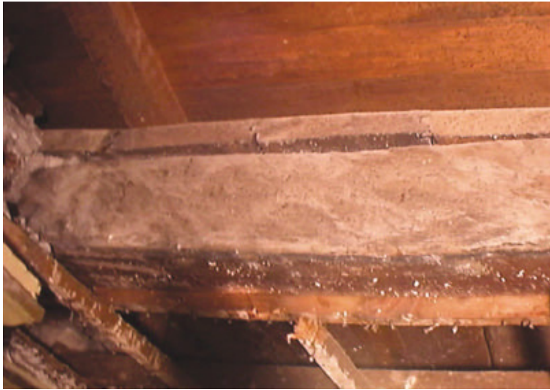
Fotografía 33. Otra vista del entablado correspondiente al sector C, en el cual se observan los anchos irregulares de los tablonés.
