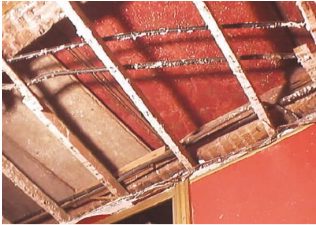
Fotografía 37. Sector A. Se visualiza la zona indicada en los gráficos como de irregularidad del entablado de 1 ½" . Dicha zona se compone por elementos de otras características, tales como restos de aberturas, sobrantes, etc.; inclusive por momentos el entablado como tal es inexistente.
