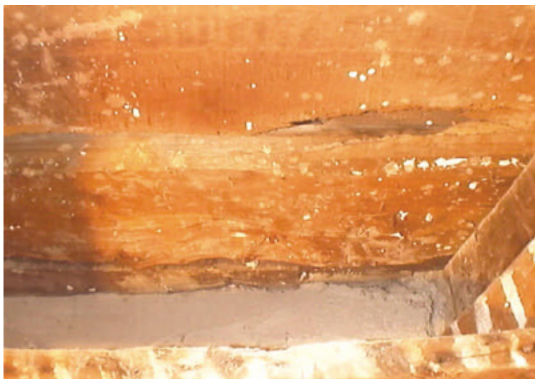
Fotografía 40. Otra imagen que muestra el mal estado del entablado en este sector.
