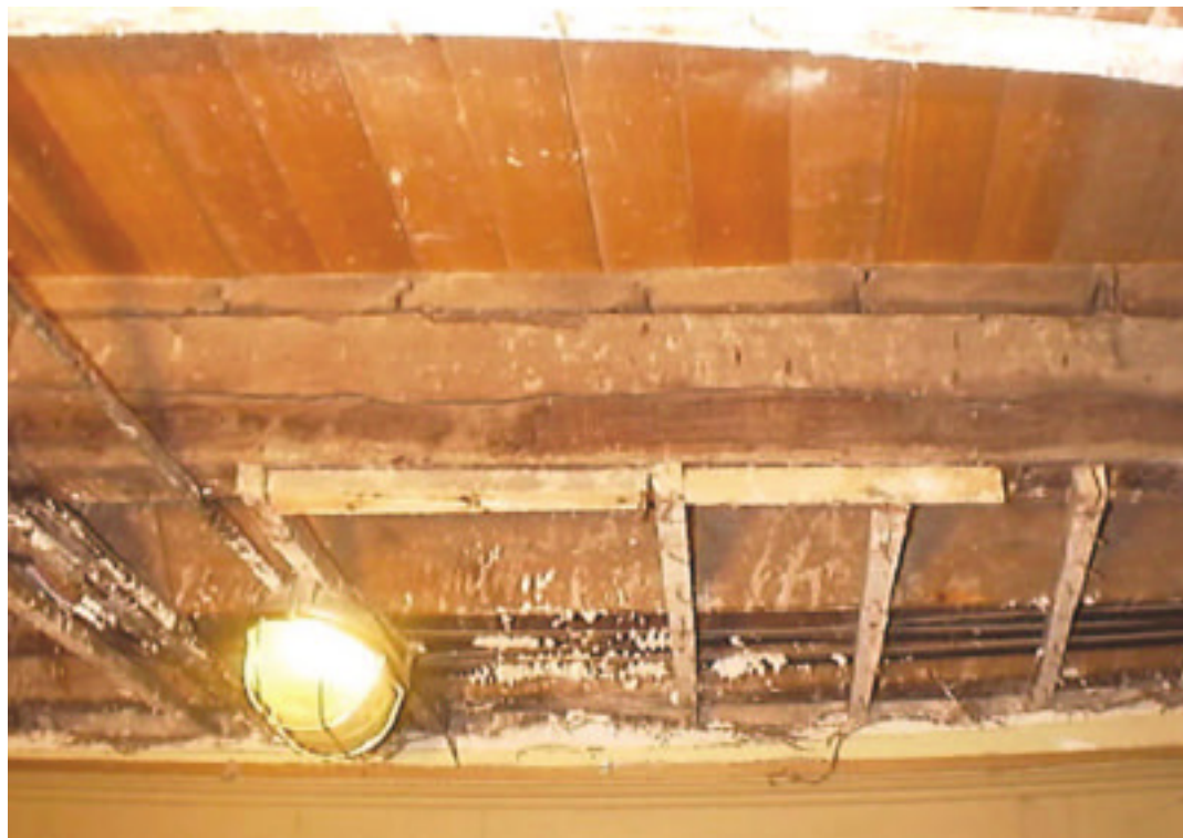
Fotografía 36. Sector C. Se observa un corte del entablado de 1 ½». A pesar de haber sufrido movimientos debido a la propia naturaleza de la madera (encogimiento en este caso), el machimbre continúa cumpliendo su función, debido a sus dimensiones.
