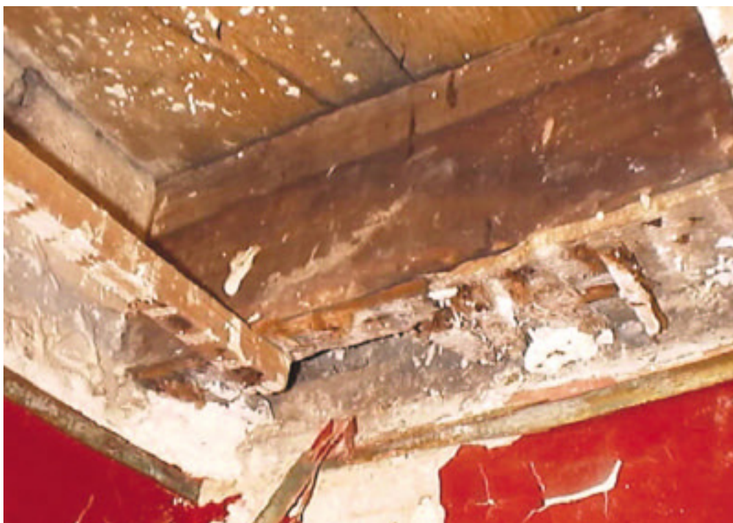
Fotografía 31. Sector A. Ejemplo de un tirante de madera dura que se encuentra próximo a un muro con signos de humedad (un sector de baños de la sala se encontraba contiguo a esta pared). A pesar de ello, el tirante se encuentra en excelente estado de conservación.
