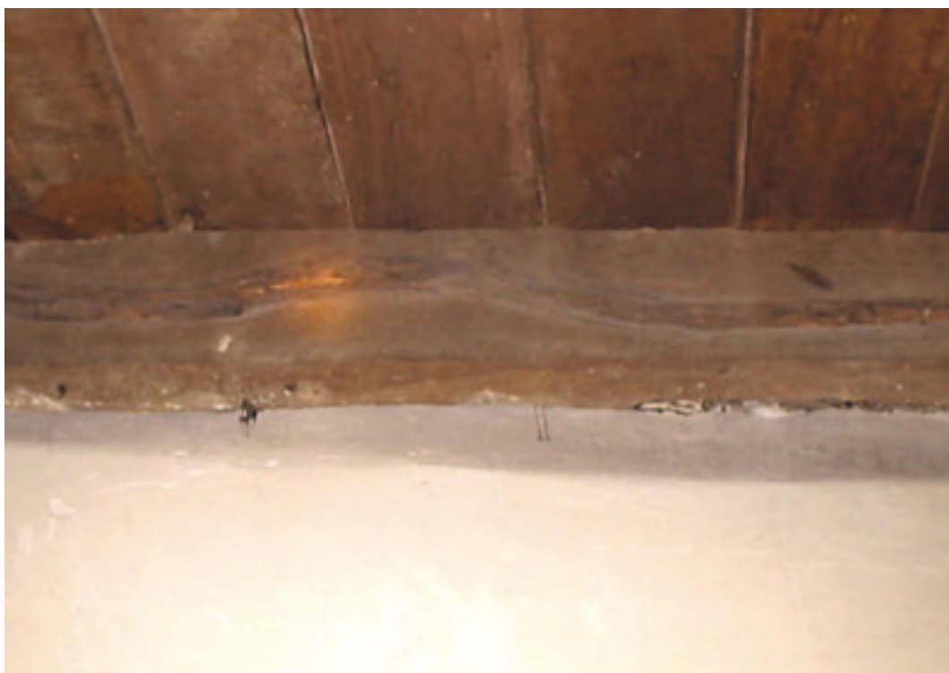
Fotografía 8. Se observan manchas de humedad, correspondientes a una "humedad seca" —esto es, no en actividad—. Dicho estado no afecta de ninguna manera al tirante de madera dura. Esta mancha de humedad tiene su origen en filtraciones que se generaron debido a la conformación de la carpeta de hormigón.
