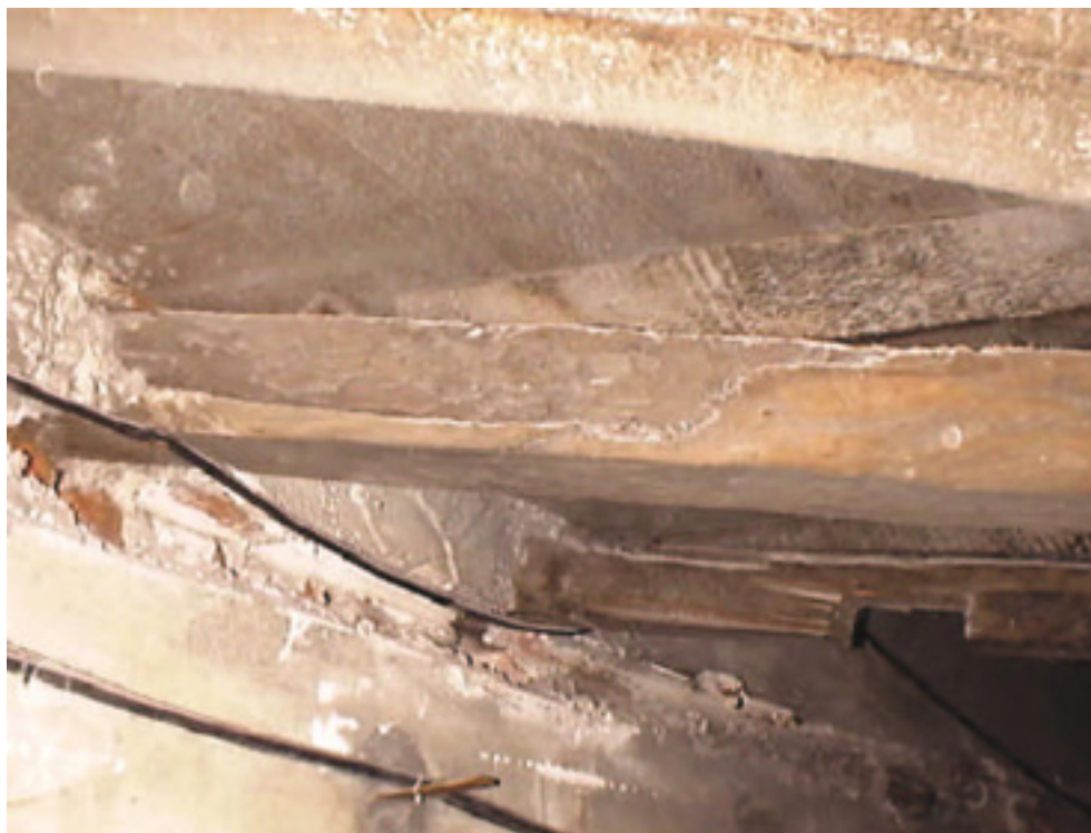
Fotografía 6. Se observa un ejemplo de viga de madera dura con sección disminuida debido al faltante de sámago y no de la madera propiamente dicha.
