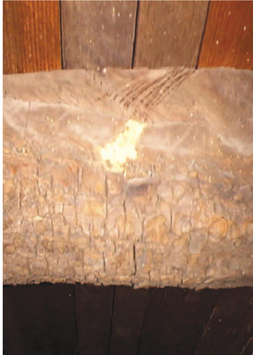
Fotografía 3. Muestra de otra viga de madera dura. Se aprecia claramente la presencia del sámago y los agujeros de polilla (actualmente sin actividad) únicamente en dicha zona. También se observa la presencia de corteza en el tirante.
