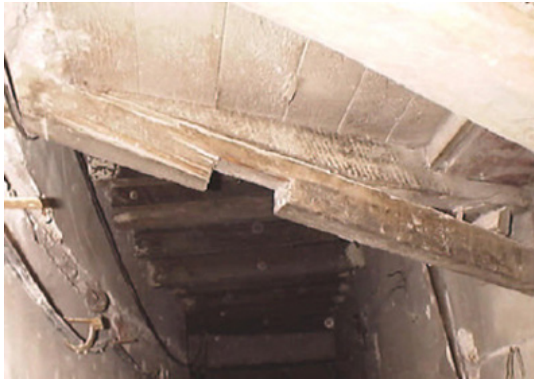
Fotografía 7. Se observa un tirante de pinotea con disminución de su sección debido a un profundo corte provocado. Asimismo, se observa la existencia de un suplemento aplicado a dicho tirante a través de otro tirante de pinotea.
