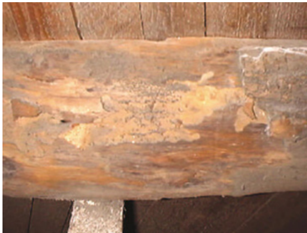
Fotografía 4. En esta viga de madera dura se aprecia el trabajo realizado por el taladro (taredo), insecto que perfora la madera, como su nombre lo indica, cuando ésta está verde. Se puede apreciar claramente que los orificios que genera son notoriamente mayores que los producidos por las polillas; en este caso se observa el recorrido realizado por el insecto entre la corteza y el sámago. Se subraya que no se observan signos de vida.
