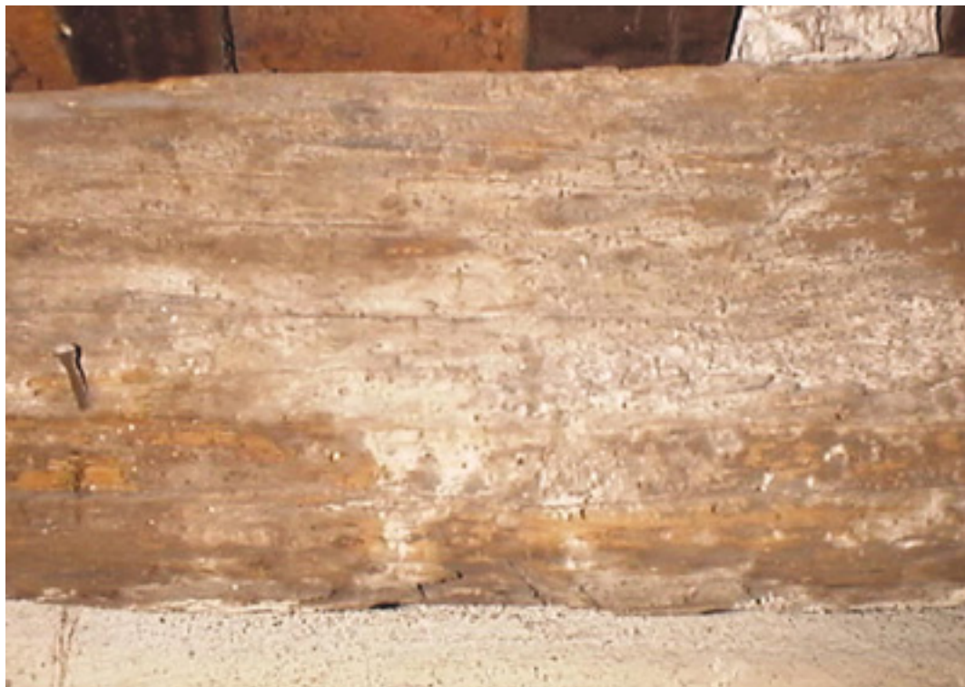
Fotografía 1. Se observa la imagen de una viga de madera dura. Si bien se aprecian rastros de agujeros de polillas, éstos se ubican en el sector del sámago y no en el sector de madera propiamente dicha. Como se ha dicho, el sámago es el sector proclive a ser afectado y tiende a corromperse más fácilmente. Esta situación no afecta en absoluto su estado de conservación, ya que no se registran signos de vida de las polillas. En tal caso, la actividad se identificaría por la presencia y caída de polvillo fino, así como también por el estado de los agujeros.
