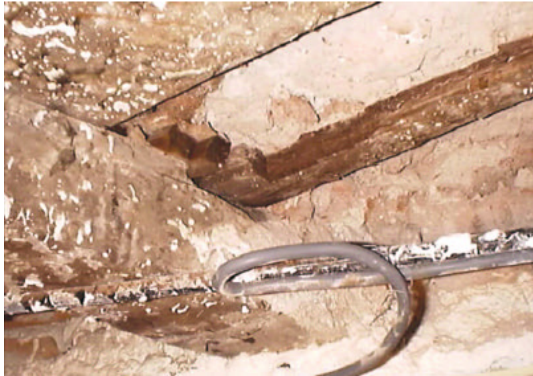
Fotografía 17. Se muestra un tablón partido correspondiente a la situación anterior, en la cual se observa el estado de "acorchamiento" descrito en la fotografía 19.
