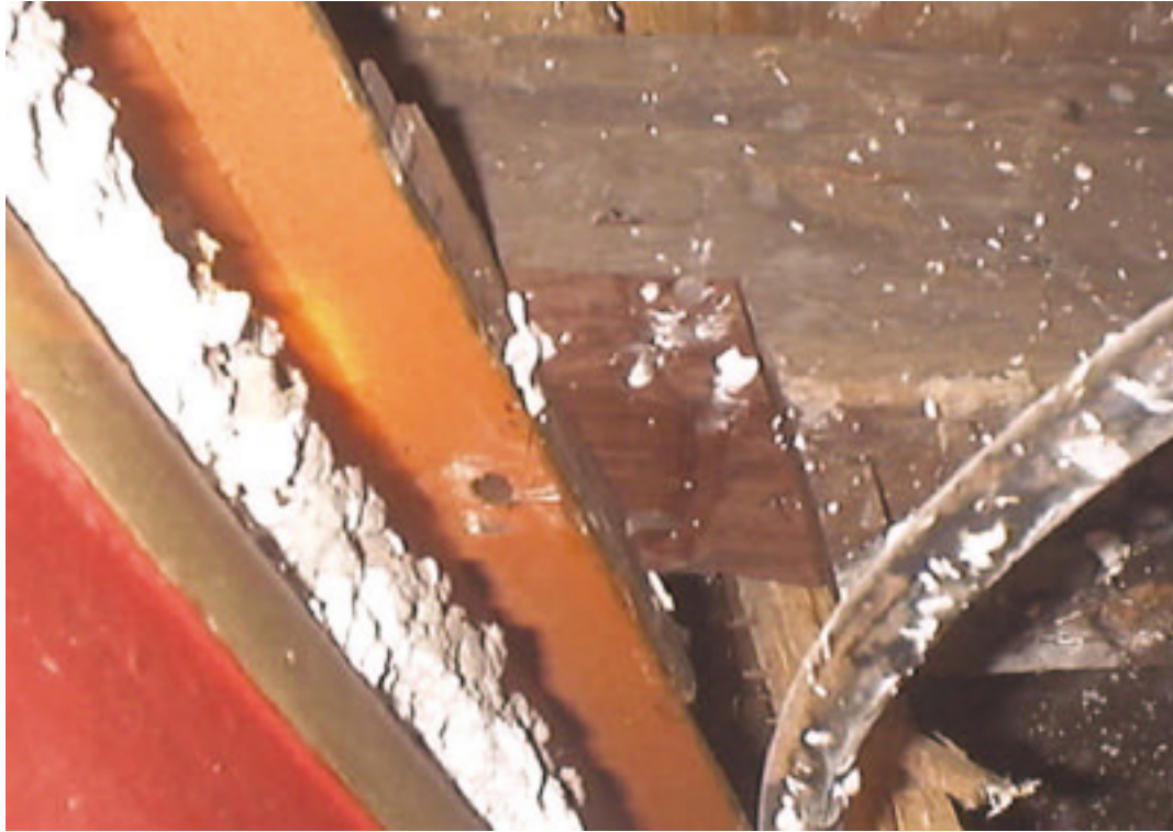
Fotografía 19. Se observa un tirante de madera dura que fue seccionado para colocar el bastidor perimetral de hierro de los tabiques de antepalcos. En dicho corte de la madera se aprecia su excelente estado de conservación.
