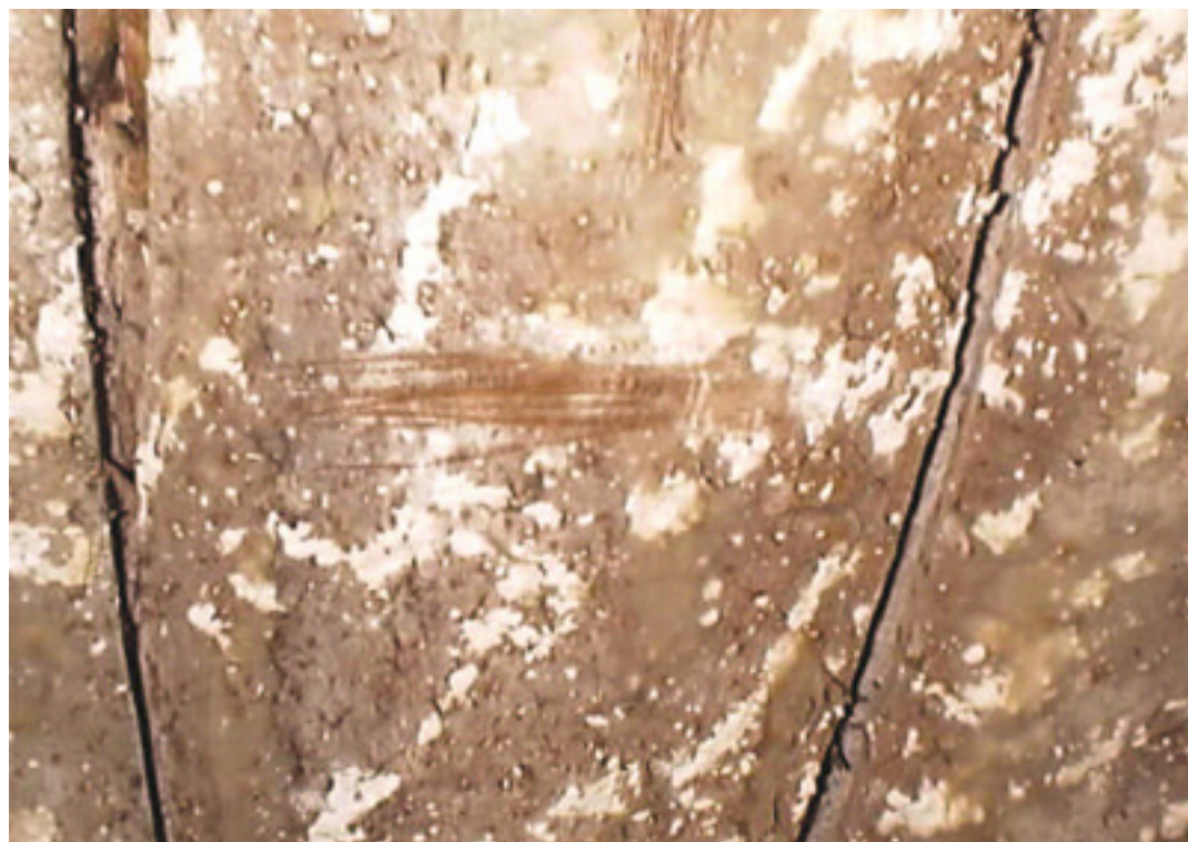
Fotografía 16. Se observa el sector del entablado con presencia de hongos en su cara inferior. De todos los niveles inspeccionados éste es el que tiene mayor cantidad de imperfecciones respecto al entablado propiamente dicho. Estos hongos probablemente fueron consecuencia a la humedad generada por la carpeta de hormigón que se realizó por encima. Su localización sugiere que posiblemente haya fallado algún tipo de impermeabilización usada en ese tiempo. De sacarse la carpeta de hormigón colocada sobre el entablado por razones de proyecto, y de mantenerse el entablado en general, se deberán sustituir las tablas que se encuentran dentro del sector determinado en los planos, debido a su mal estado de conservación (acorchamiento). Si no se quitara la carpeta de hormigón, sería innecesario sustituirlas, ya que no cumplirían función alguna.
