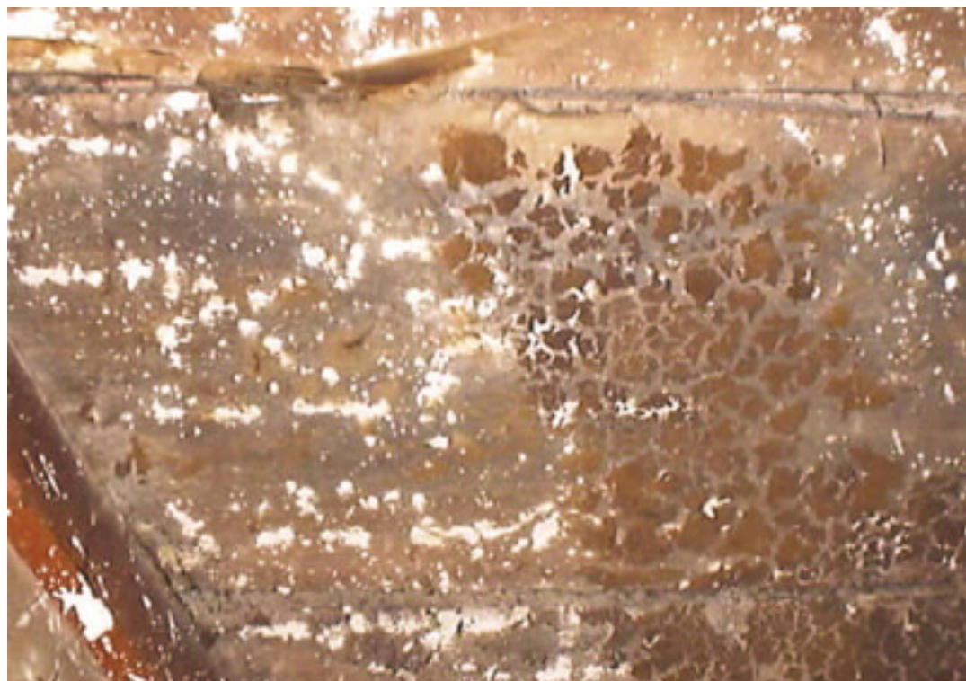
Fotografía 18. Efectos producidos por la humedad, muy probablemente debida a la carpeta de hormigón realizada sobre el entablado. Se observa la presencia de hongos y craqueladuras en la pintura de los tablonos de este sector. Su estado de conservación no representa ningún riesgo si se le brinda el tratamiento adecuado.
