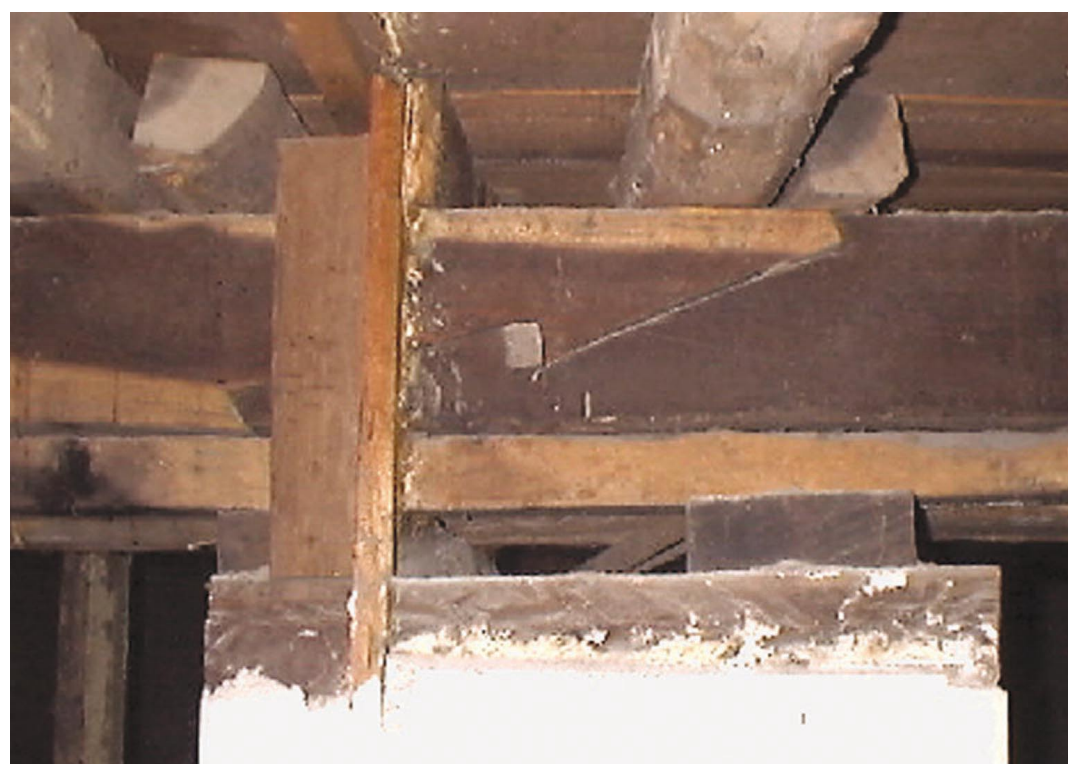
Fotografía 4. Detalle de la unión en rayo de Júpiter con llave de las vigas principales.
