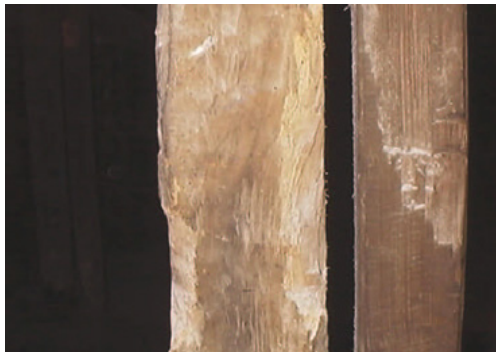
Fotografía 2. Presencia de rastros de polilla en los pilares en el sector de sámago. No existen signos de vida de alguna especie en los palos de madera dura (polvillo blanco), lo que implica que se encuentra en excelente estado de conservación; no así los tirantes de pinotea, los cuales se encuentran actualmente atacados por la polilla. Para cuando se realice su desarme, se aconseja practicarles baños de inmersión en pentaclorofenol o similar. Su estado de conservación es regular.
