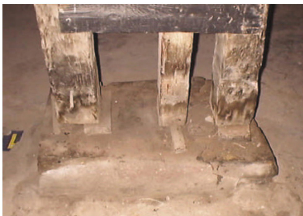
Fotografía 8. Detalle del asentamiento de los pilares sobre piedra (situación 1).
