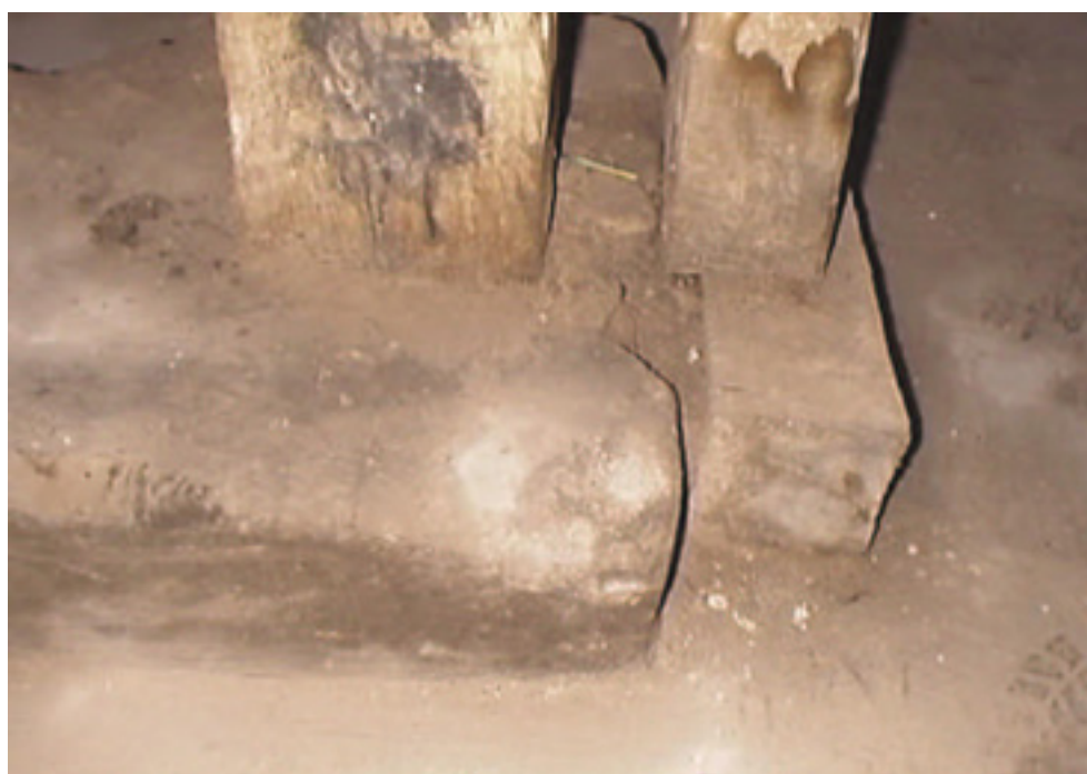
Fotografía 9. Detalle del asentamiento de los pilares sobre piedra (situación 2).
