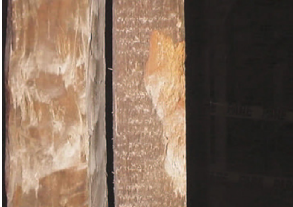
Fotografía 3. Detalle de pilar de pino atacado por la polilla.
