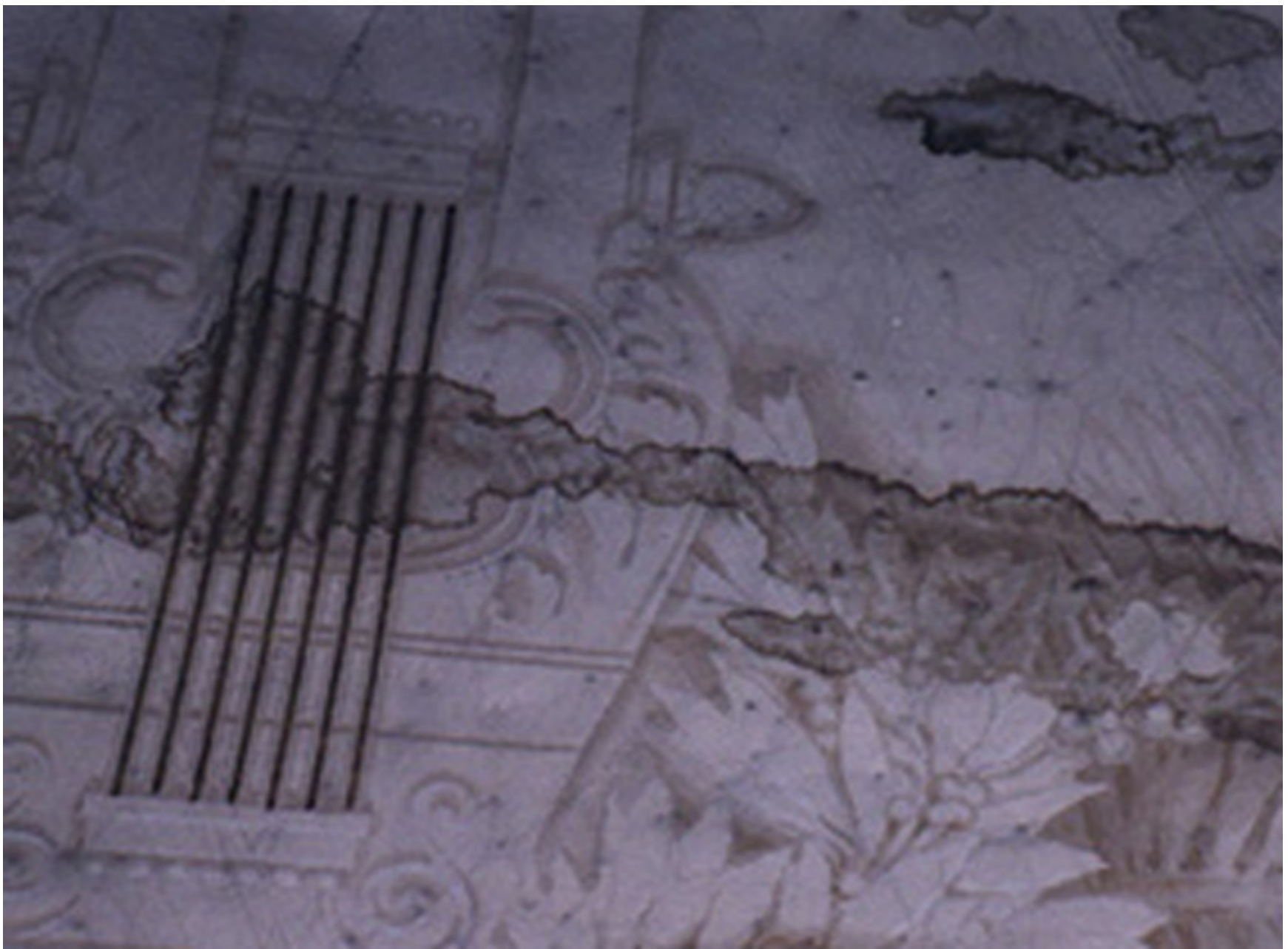
Fotografía 6. Ejemplo de manchas de humedad mostrando zonas de mayor acumulación en los límites de cada mancha.
