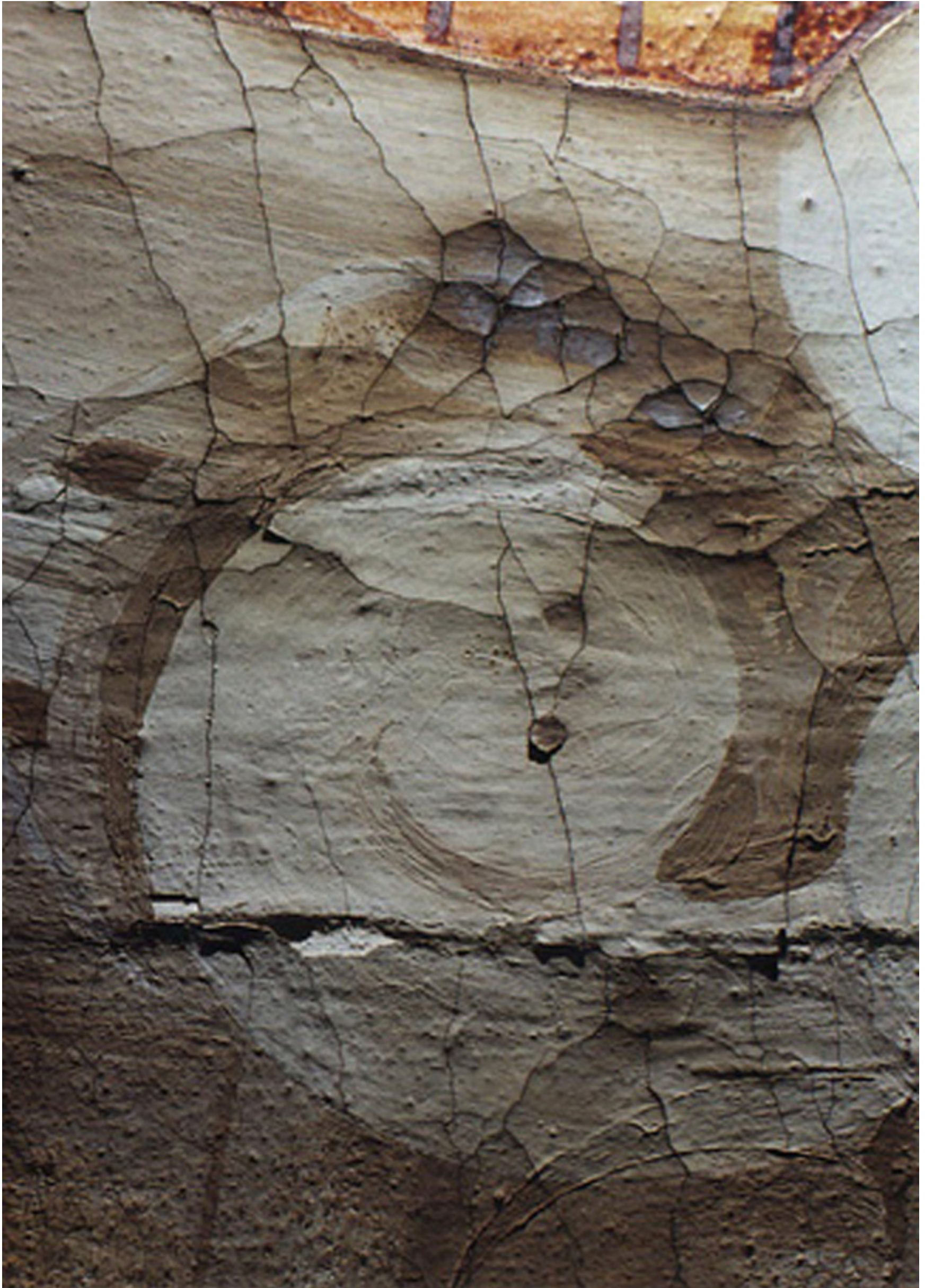
Fotografía 8. En el sector de estudio se pueden ver zonas de inestabilidad de la capa pictórica, con desprendimientos totales (faltantes), craquelados y desprendimientos parciales de forma cóncava (detalle de la ventana H).
