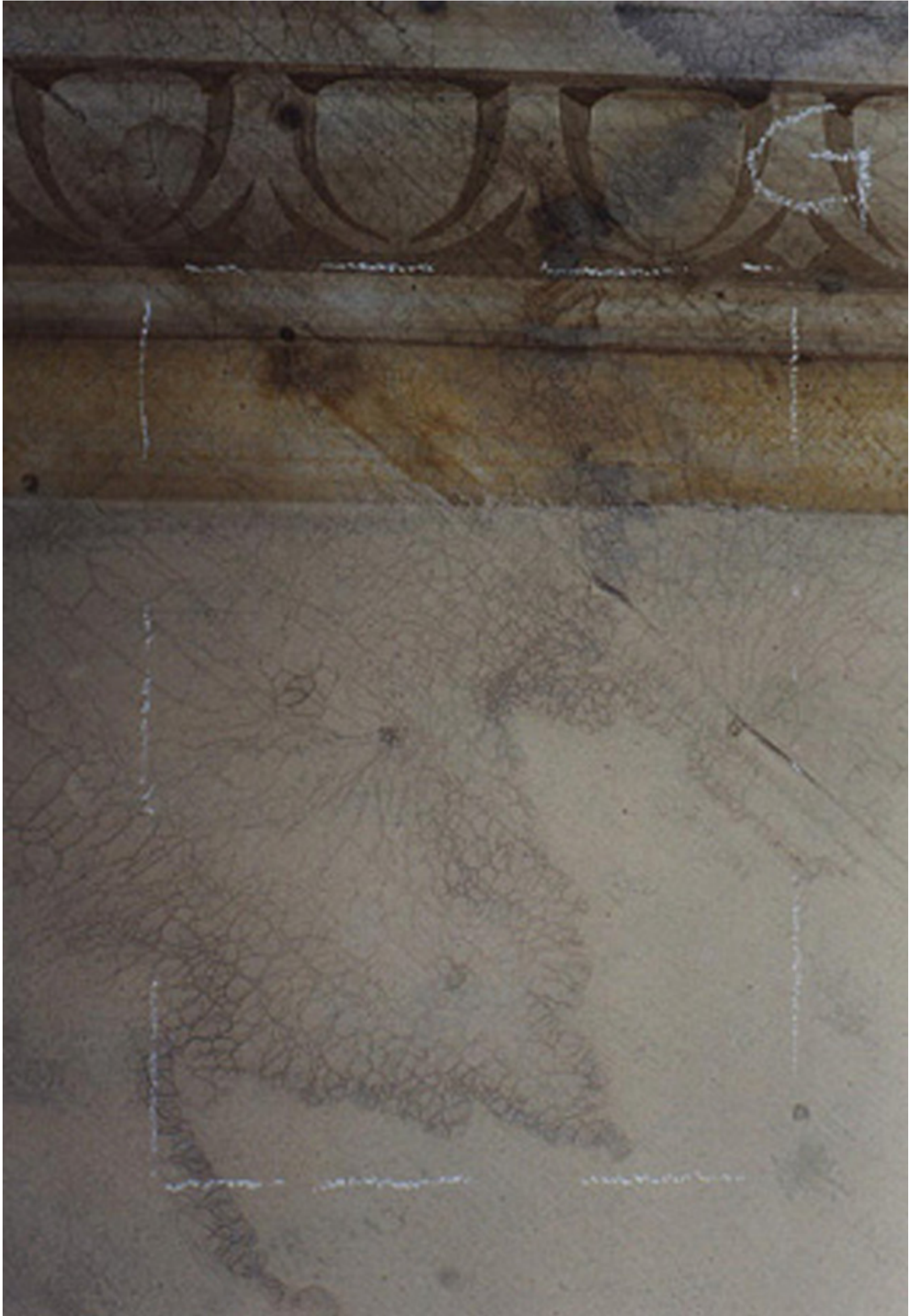
Fotografía 13: A través de los repintes realizados sobre manchas de humedad se observa que éstas afloran nuevamente (ventana G).
