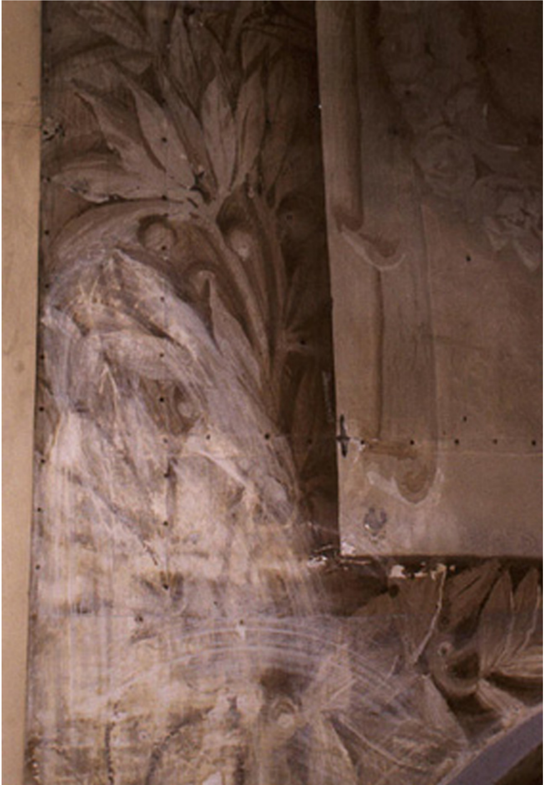
Fotografía 14: Detalle de intentos de limpieza en la zona de la Galería Alta.
