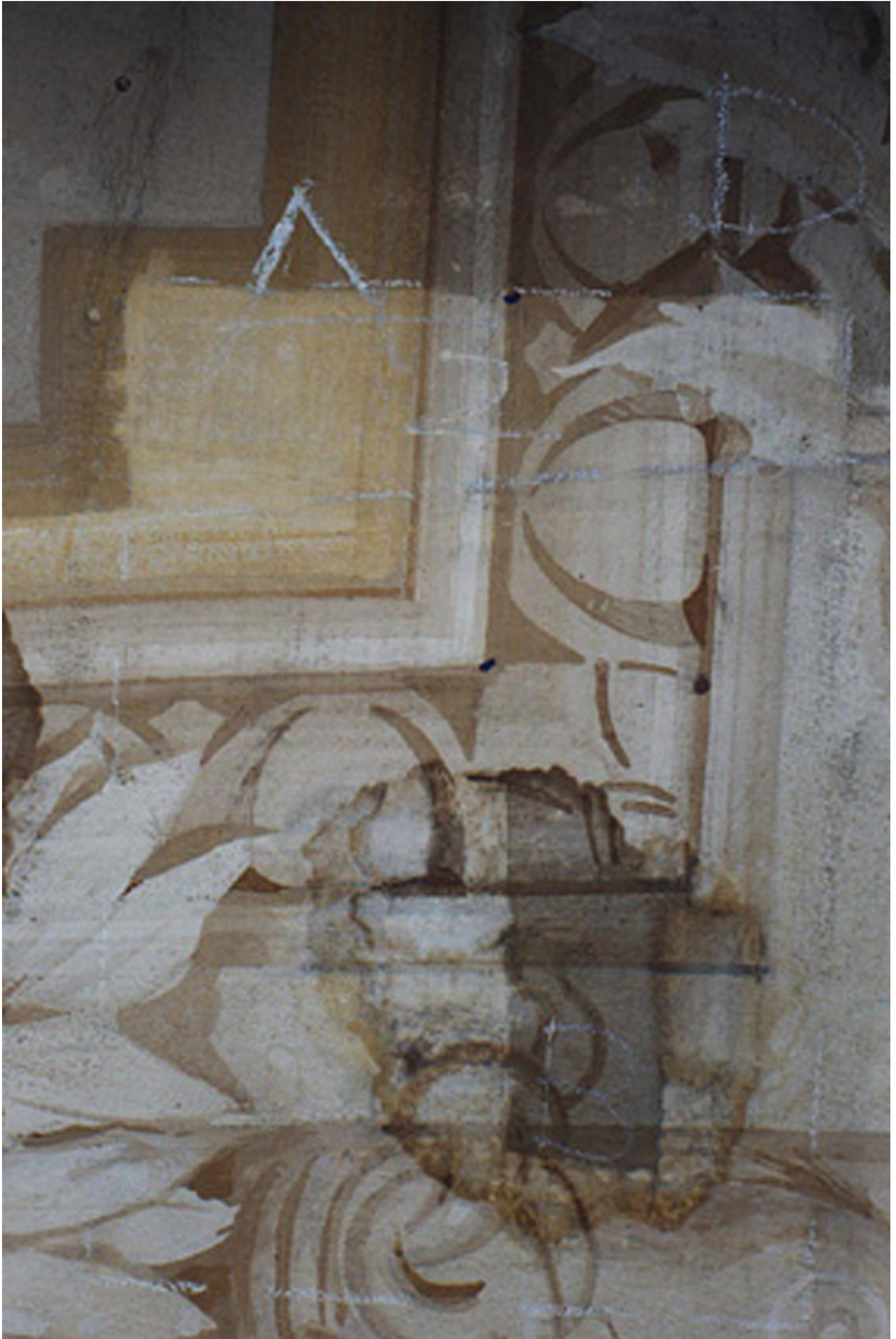
Fotografía 17. Detalle después del tratamiento parcial de reducción de manchas de humedad en la ventana D.
