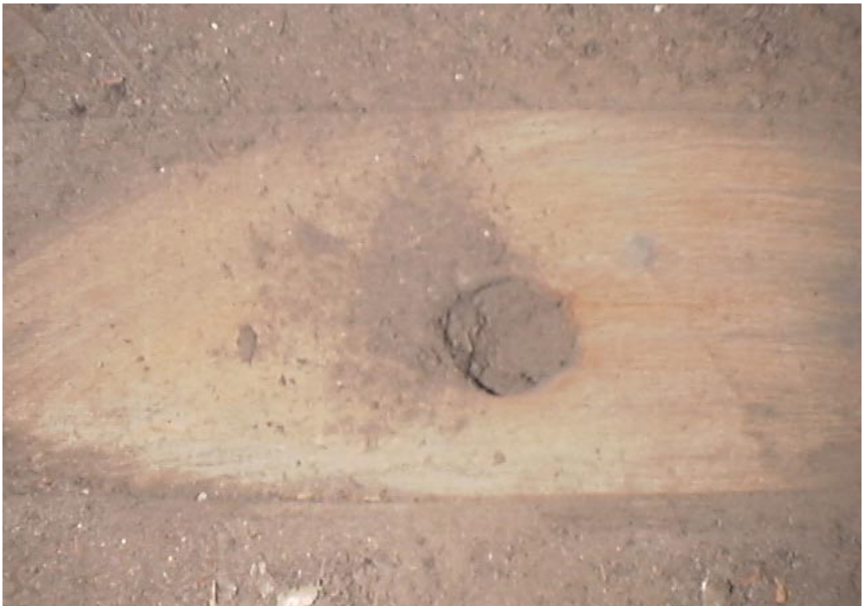
Fotografía 4. El entablonado presenta algunos nudos ya salidos. Estos faltantes traen aparejadas entradas importantes de humedad y polvo para la tela. Después de practicada la limpieza aconsejada, se procederá a sellar dichos nudos.
