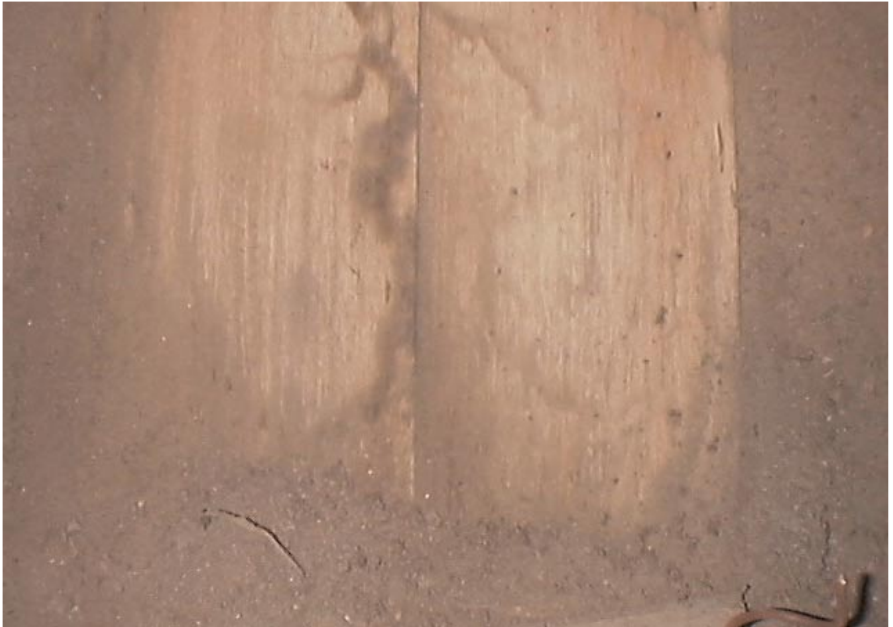
Fotografía 3. Detalle del entablonado luego de aplicársele una limpieza con cepillo de paja. Se observa el tipo de madera (pino blanco) y su excelente estado de conservación, así como también manchas viejas de humedad que actualmente no lo afectan en absoluto.
