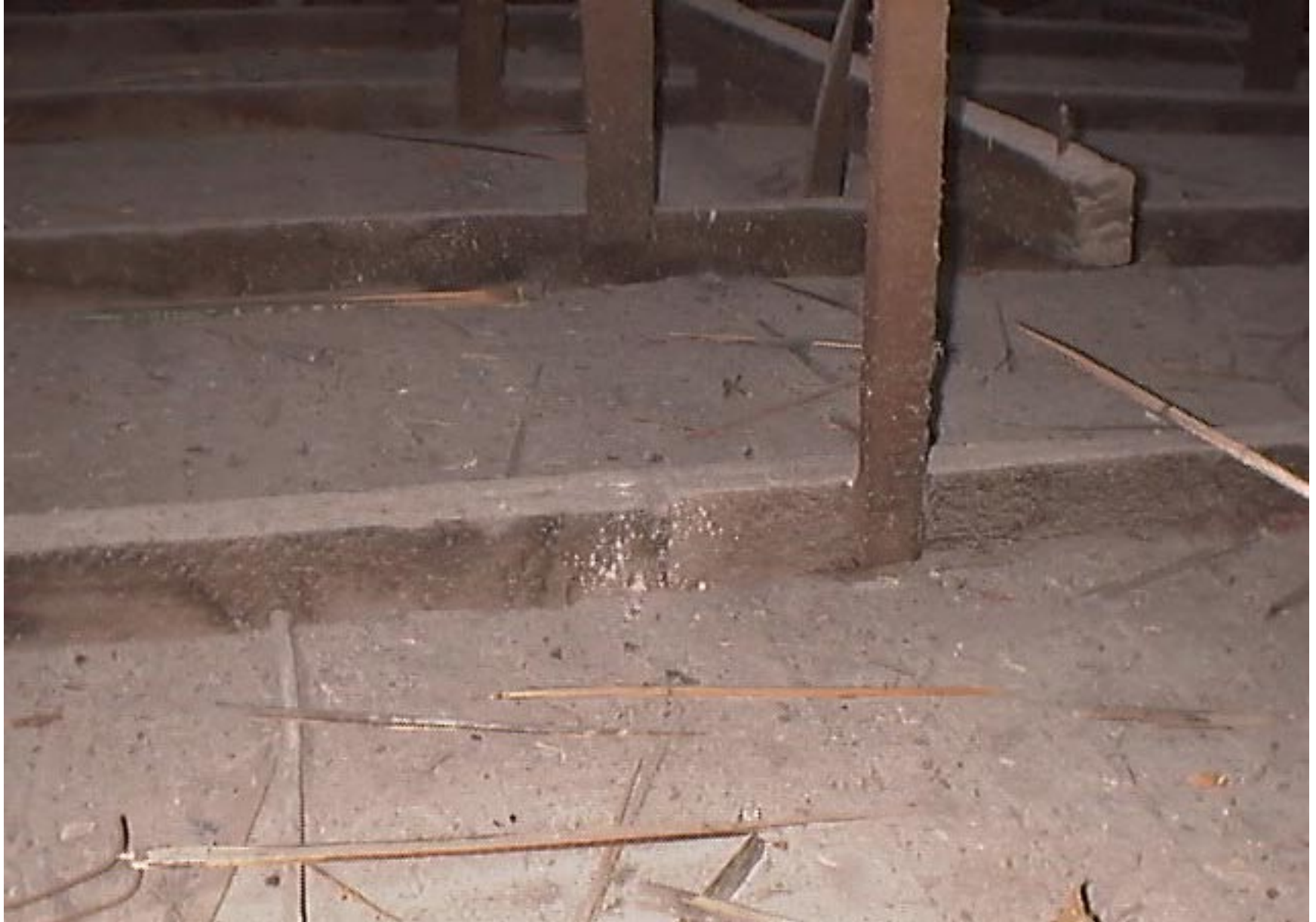
Fotografía 1. Muestra parcial del conjunto de costillas estructurales. Se aprecia la acumulación de polvo, suciedad y restos de madera por encima del entablado. Dicha suciedad no permite distinguir entre una tabla y otra del entablado.
