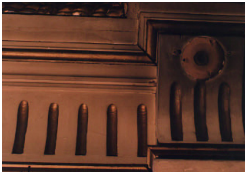
Fotografía 3. Parte inferior del frente de palco. Se observan grietas
