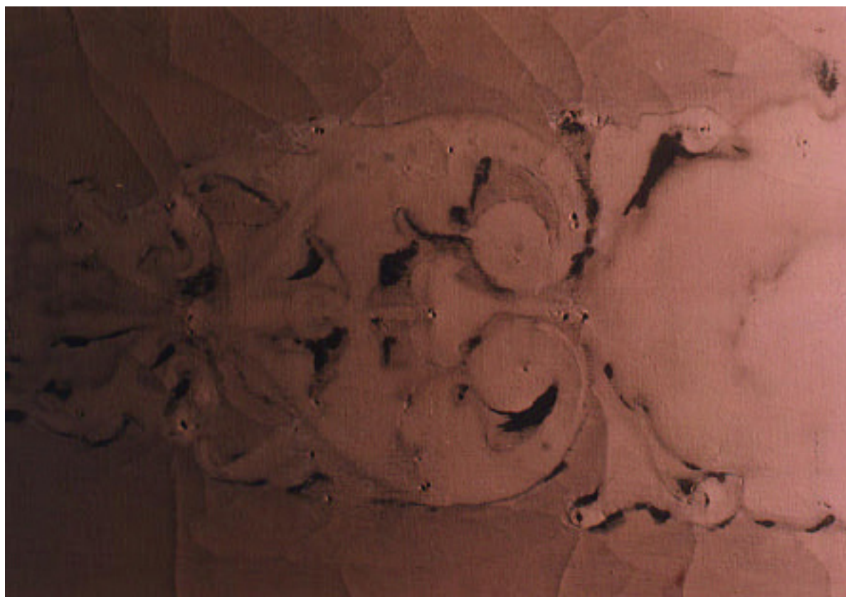
Fotografía 6. Detalle de la tela del rectángulo central del frente de palco, que muestra la formación de grietas.
